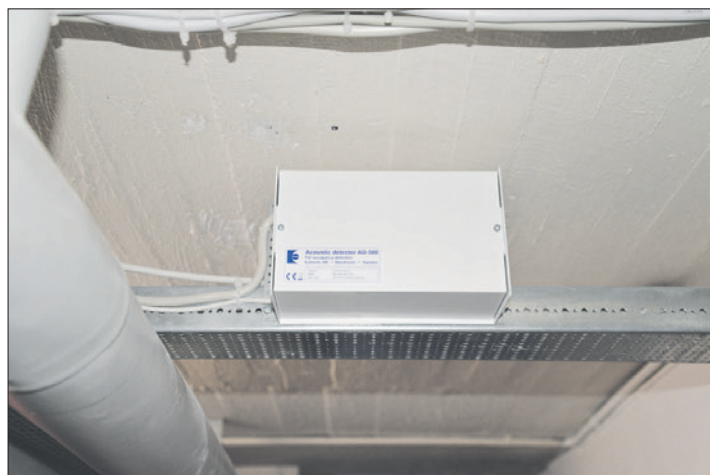
Lyset i kælder og i opgange er udskiftet med LED-rør og akustiksensorer i stedet for tryknap, hvilket har mindsket elregningen i bebyggelsen.
